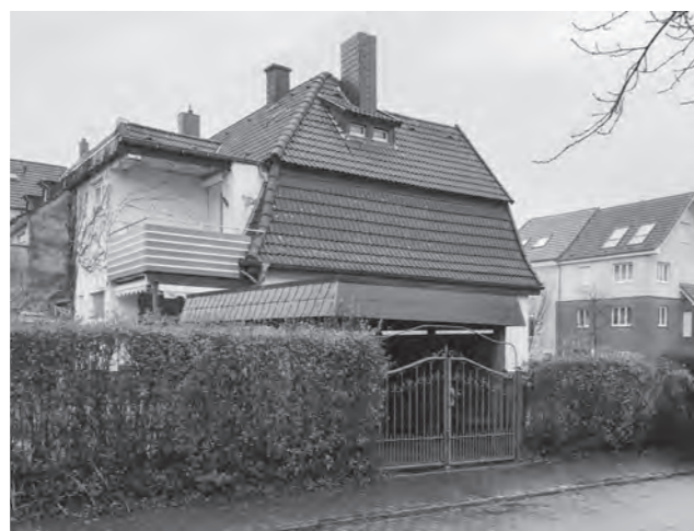
2022 Das Kasernenhaus ist rücksichtlich durch einen Anbau aus den 1970er Jahren verbaut. Beginn Rückbau des mangelhaften Anbaus.
